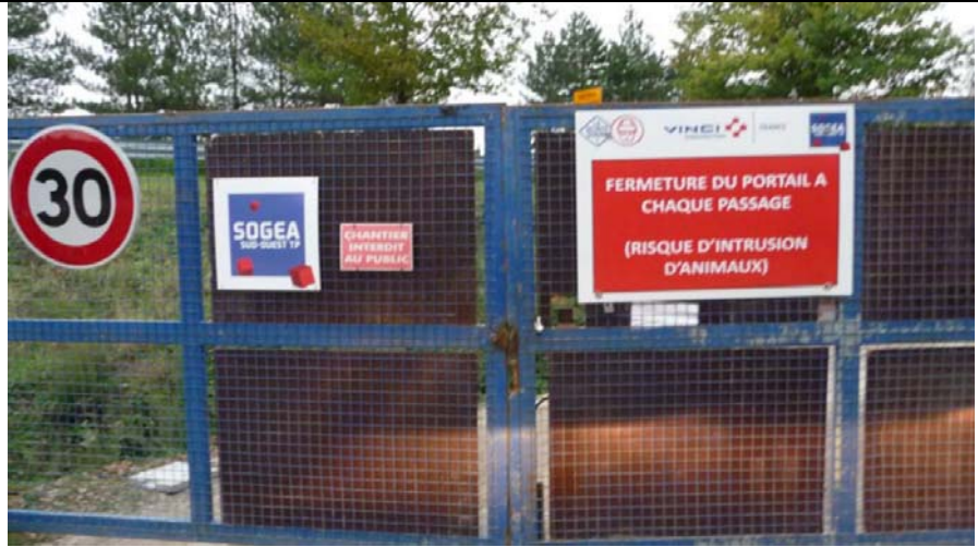
Dispositif de portail de chantier avec panneau indiquant la fermeture obligatoire à chaque passage en raison du risque de pénétration de la faune – Photo : Ecosphère
